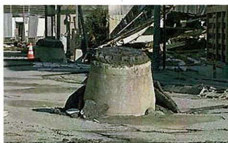
【1m飛び出したマンホール】
