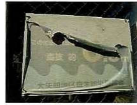
[表示板の劣化]
