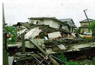
1階が圧壊した木造住宅
